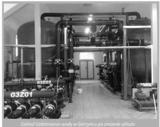
Zakład Uzdantniania wody w Górzeńcu po zmianie układu
