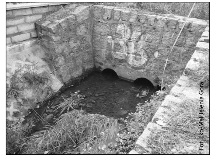
W wielu miejscach przepusty są zbyt małe, aby woda swobodnie płynęła
